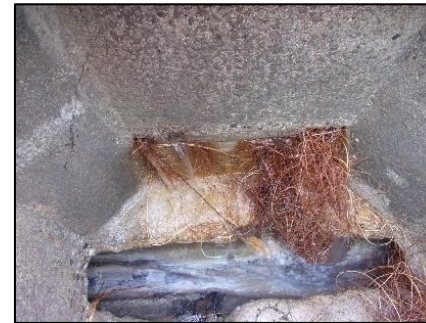
Intrusions de racines (étanchéité, difficulté d'écoulement)
