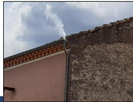
Gouttière raccordée vers EU
